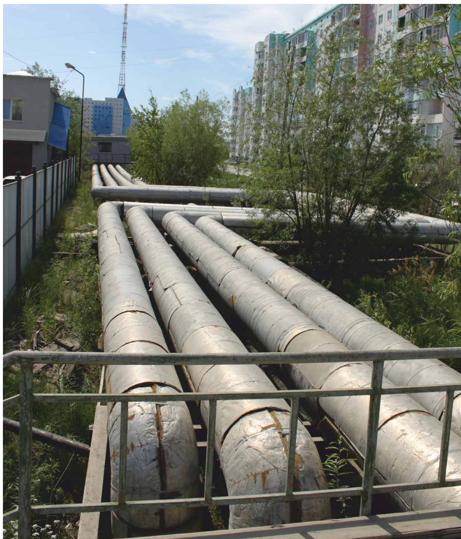
Vodovodné potrubia na povrchu, zdroj: archív saleziánskej komunity v Jakutsku
