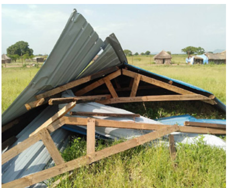
Spadnutá strecha po silnej búrke
